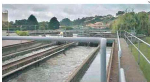
La depuradora de Areamilla gestionada por la UTE.
